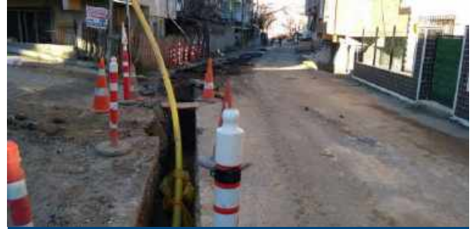
Doğalgaz Poletilen Hat
