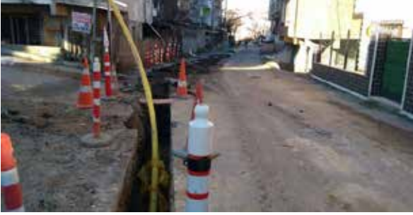
Doğalgaz Poletilen Hat
