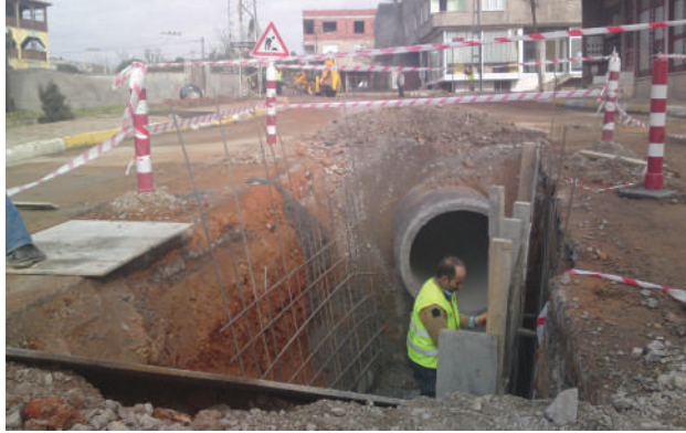
Yağmursuyu Hattının Temizlik Ve Bakımlarının Rahat Yapılabilmesi İçin Yapılan Muayene Bacaları
